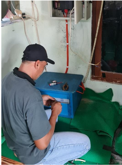
Gambar 2. Penyambungan Batere Dengan Kabel Tembaga
