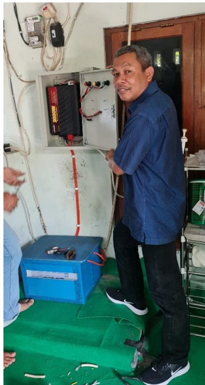
Gambar 3. Hasil Pemasangan Inverter Dengan Batere Kotak Berwarna Biru
