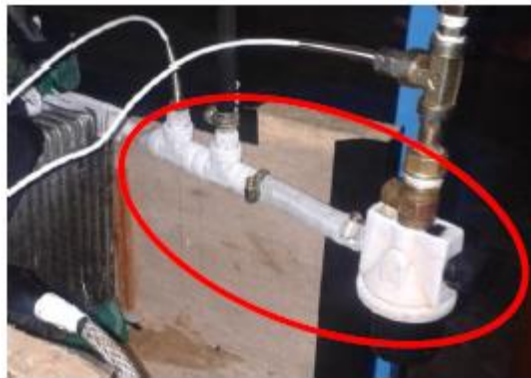
Gambar 2.3 Icing/ freezing pada katup ekspansi
