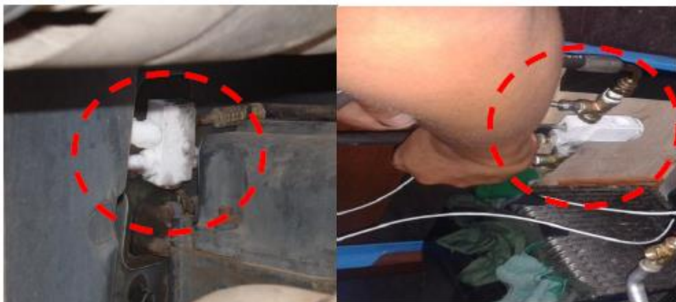
Gambar 1.1. Peristiwa icing pada katup ekspansi
